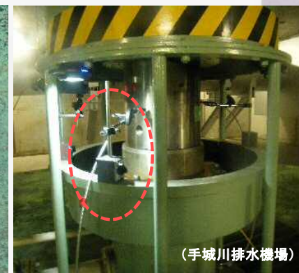
センサーの設置状況
