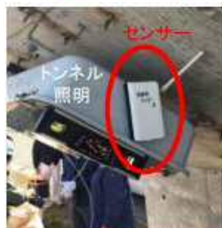
トンネル内附属物の 異常監視センサ
