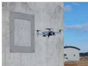
ドローンによる損傷把握
